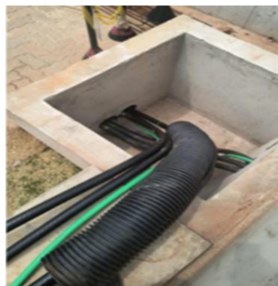
Figura 6 – Situação encontrada na caixa de passagem durante processo de instalação.
